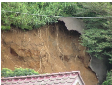
写真-1 モルタル吹付斜面の崩壊 (地山は土砂状)
